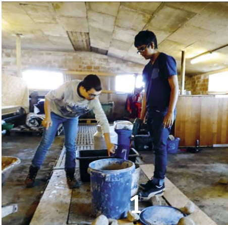
1 Zement mit Wasser und Sand mischen und anrühren für die Fertigung der Tisch-Fundamente
